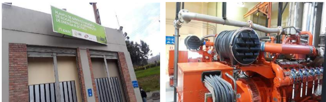
FOTO 2 PLANTA DE BIOGAS
